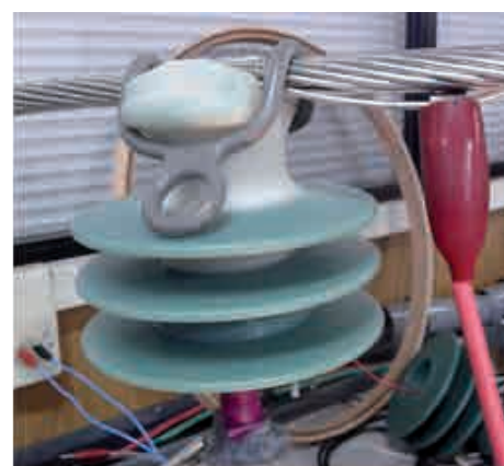
Isolador inteligente com defeito artificial indicando a existência de descargas
